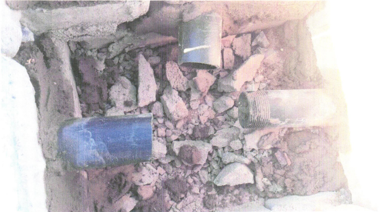
Foto 01- ELETRODUTO RÍGIDO ROSCÁVEL
