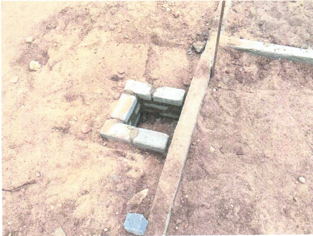
Foto 03 - CAIXA ENTERRADA ELÉTRICA RETANGULAR, EM ALVENARIA COM TIJOLOS CERÂMICOS MACIÇOS, FUNDO COM BRITA, DIMENSÕES INTERNAS: 0,3X0,3X0,3 M. AF_12/2020
